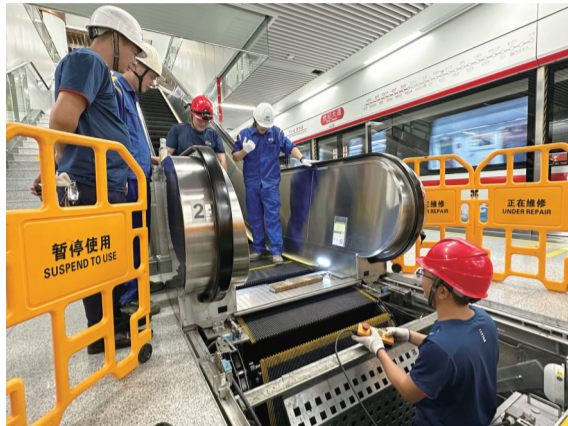
检验员正在检测电梯。 记者王玮丽
