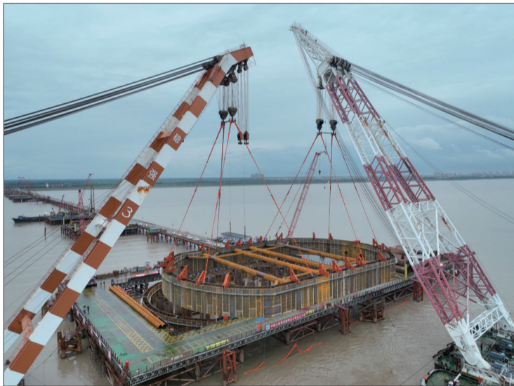
昨天在启东市拍摄的崇启公铁长江大桥3号主墩大承台双壁钢围堰吊装现场。两个双壁钢围堰一天吊装成功,创造了该项目奇迹,标志着两个主墩全部进入大承台施工。 记者许丛军
