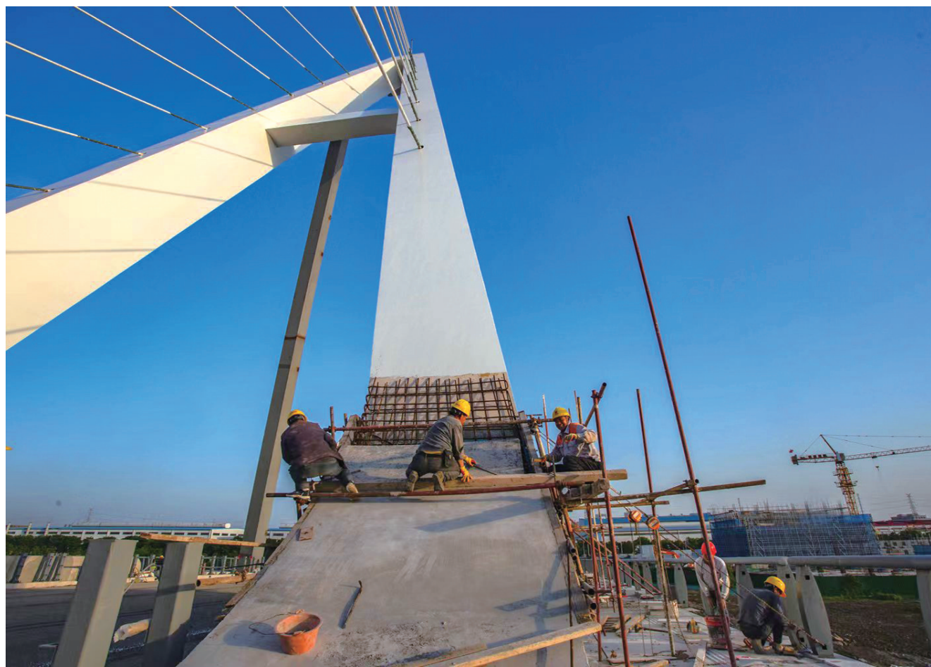
13日,连接崇川区与通州区的太平路大桥现场一派繁忙景象。该大桥主体工程已完成,工人正在进行附属设施施工。 钱伟章摄
